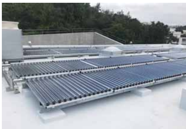
■福祉施設（沖縄県） 機種：ソラリス 型式：T-CPC1514 台数：50台 集熱面積：117㎡ 用途：給湯補助
