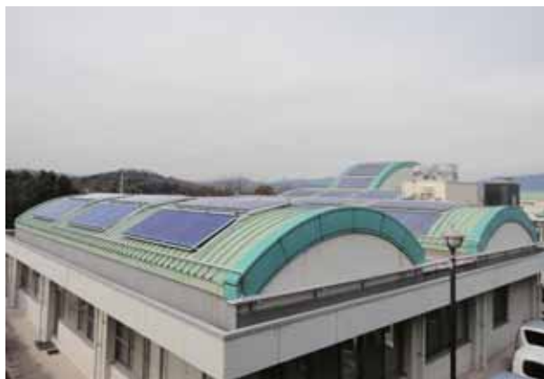
■福祉施設（広島県） 機種：ソラリス 型式：CPC1512 台数：93台 集熱面積：186㎡ 用途：給湯補助
