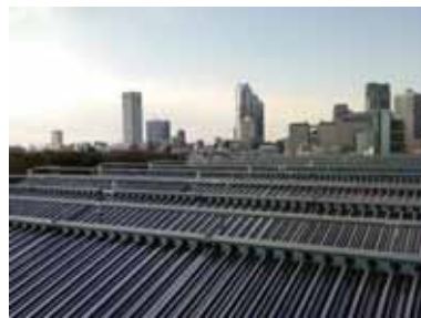
オフィスビル(空調利用)におけるCPC1512 174台設置の年間シミュレーション
