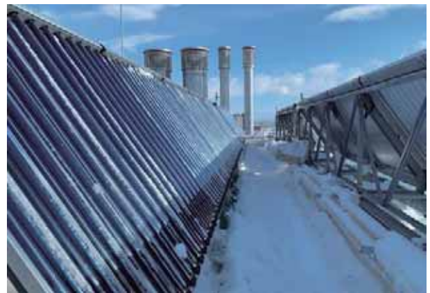
■オフィスビル（北海道） 機種：ソラリス 型式：T-CPC1514 台数：51台 集熱面積：119㎡ 用途：空調補助
